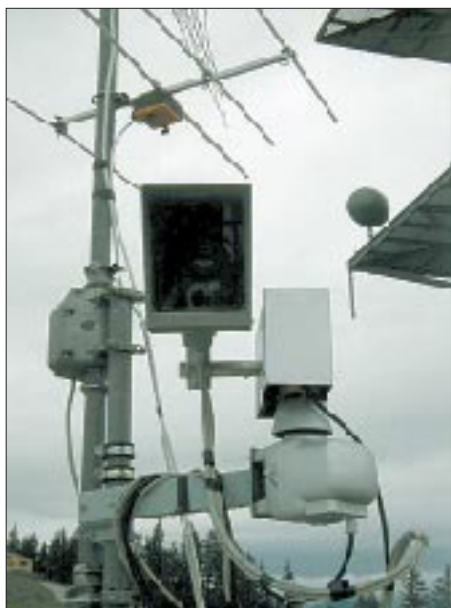
Antennenanlage und Steuergeräte des ATV-Relais
